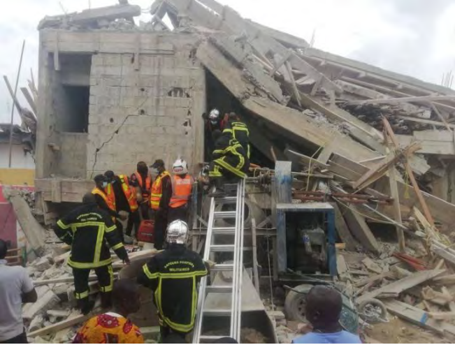
Effondrement d'un immeuble en construction à Anono, le 12 mars 2021. Un « phénomène » de plus en plus fréquent à cause des normes de construction non respectées.
