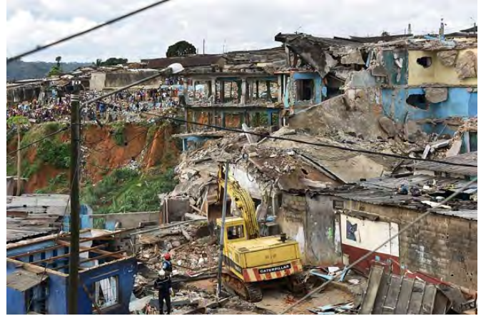
Le 2 Juillet 2015, au moins trois personnes ont trouvé la mort à Yopougon-Gesco-Manutention, électrocutées par un câble électrique après la chute d'un poteau.
